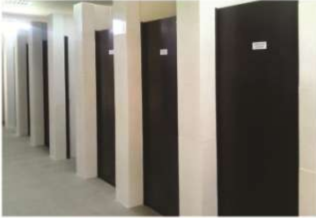
Pintu uPVC Kamar Ganti Wanita.
